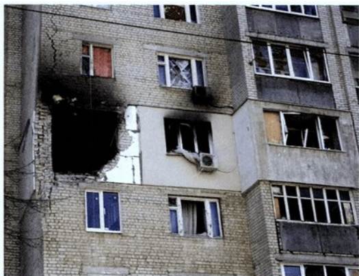
Zerstörtes Wohnhaus in Charkiw (© Caritas Spes-Ukraine)
